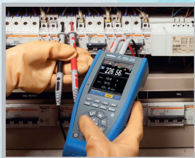
Mesures sur armoires électriques
