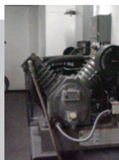
Compresseur d'air - Image visible intégrale
