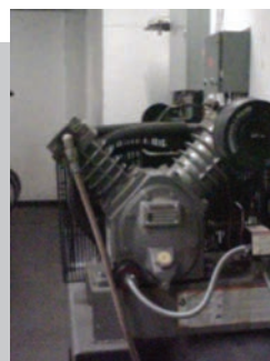
Compresseur d'air - Image visible intégrale
