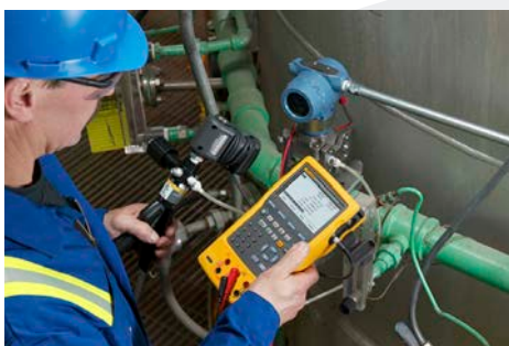
◀ FLUKE-754 Contrôle de l'indication de pression avec la boucle de courant
