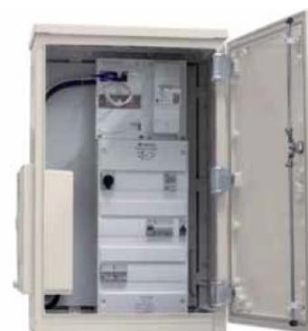
Armoire de rue câblée
