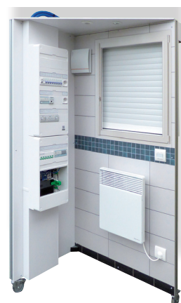
GTL - Détail Salle de bain
