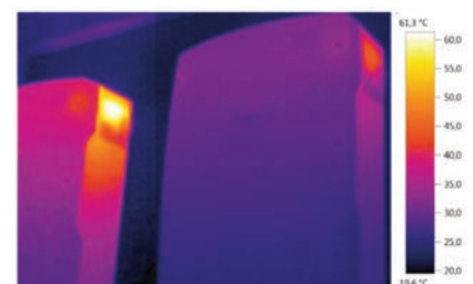
Surchauffe d'un onduleur
